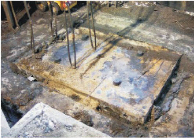
随着基础混凝土浆状物质从下面渗出， 锻锤底部钢板出现倾斜
